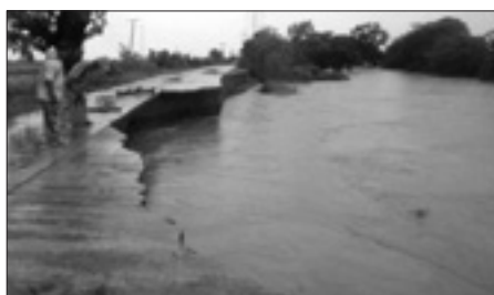
Strada distrutta dalle acque nella città di Bacarra (Ansa)
